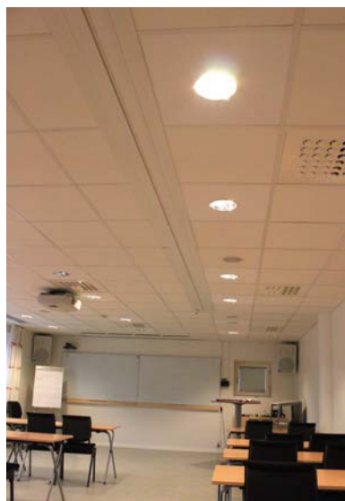
Figur 27. I denna undervisningslokal har armaturer avsedda för montering vid högre takhöjder monterats på 2,4 m höjd. Dessutom valdes en modell med lågt infällningsdjup på grund av begränsat utrymme mellan bjälklag och innertak. Resultatet blev kraftigt bländande ljuspunkter alltför nära de centrala delarna av synfältet. Vid eftermontering av bästa tillgängliga bländskydd minskade bländningen något men är fortfarande besvärande. Exemplet betonar vikten av belysningskompetens hos projektören samt krav på provinstallation som en del i köparens beställarkompetens.
