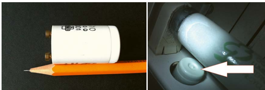
Figur 22. Glimtändare finns i äldre lysrörsarmaturer och är normalt relativt lätta att komma åt vid behov av utbyte. Lysröret kan dock behöva lossas.
