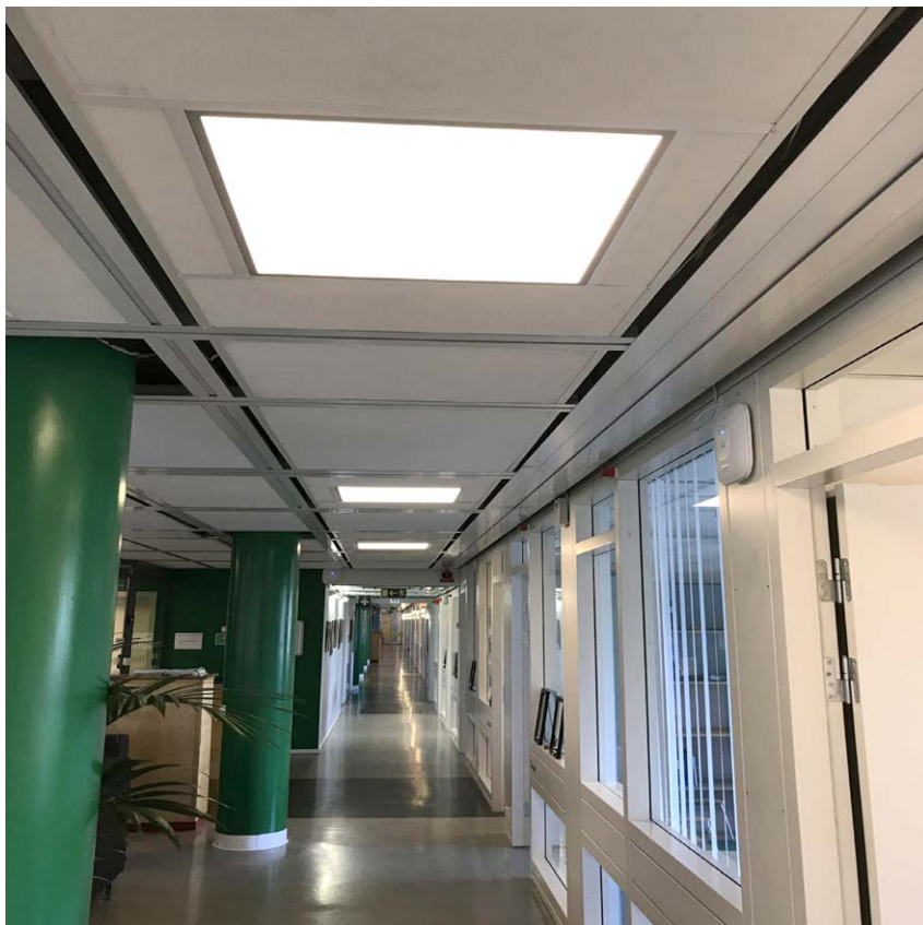
Figur 25. Här har LED-plattor ersatt de lampetter som syns längre bort i korridoren.
